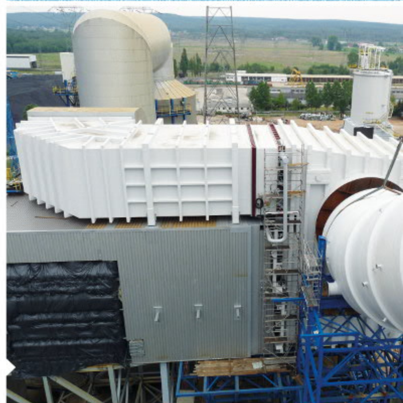
Square duct in GRP 5.000 x 8.000 x 14.000 mm
