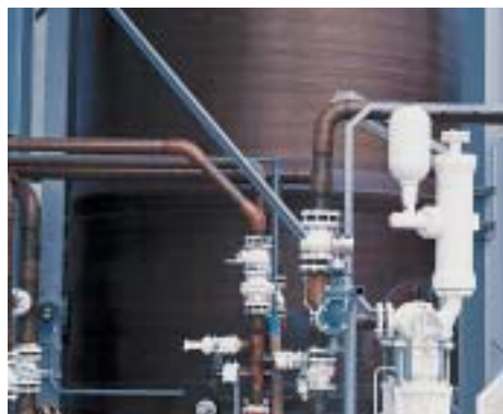
Prozessbehälter mit Rohrleitungen Process container with pipelines
